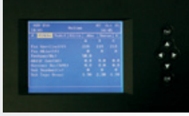
UPS Kabinisi Kontrol Paneli
